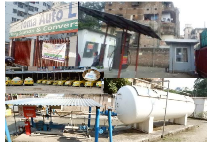
TOMA社のオートガス設備 (敷地内工場では、エンジンのLP転換も実施)
